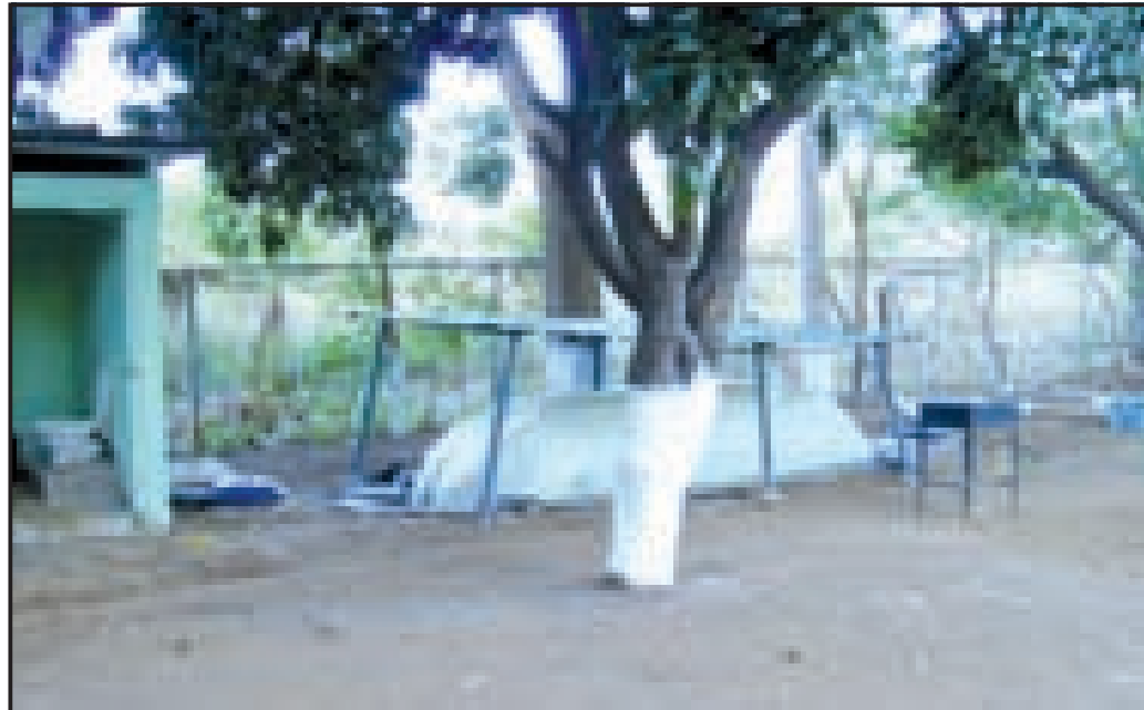
Biodigestor alimentado por excretas humanas, instalado en cancha deportiva de CIPRES Managua
