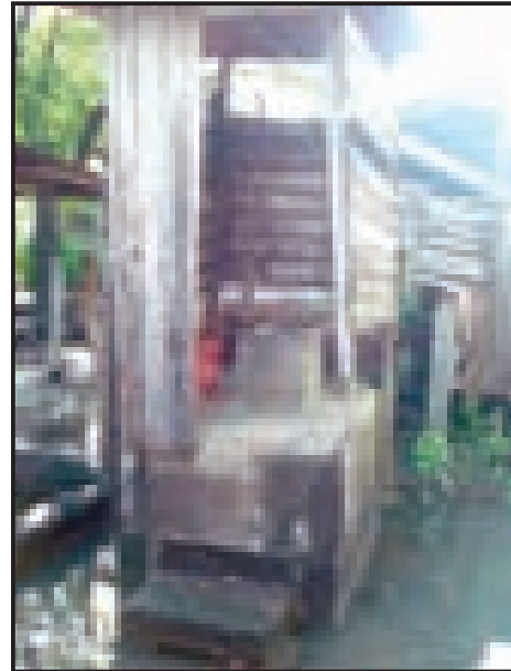
Letrina Pon-Pon-elevada-inundada en Tipitapa
